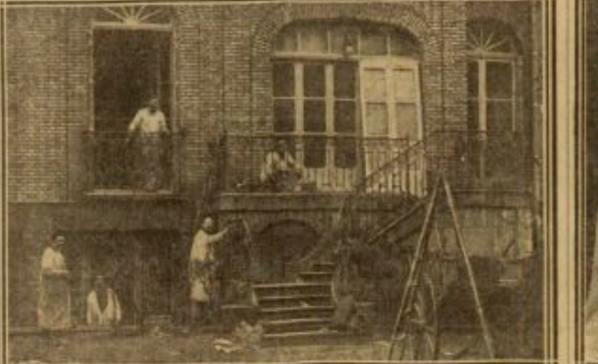
LES PEINTRES DONNENT LA SECONDE COUCHE AUX FERRONNERIES. Depuis que M. Raymond Poincaré a fait choix d'un hôtel, rue Marbot, pour s'y installer, le 16 février, on ne cesse d'y travailler fébrilement.
